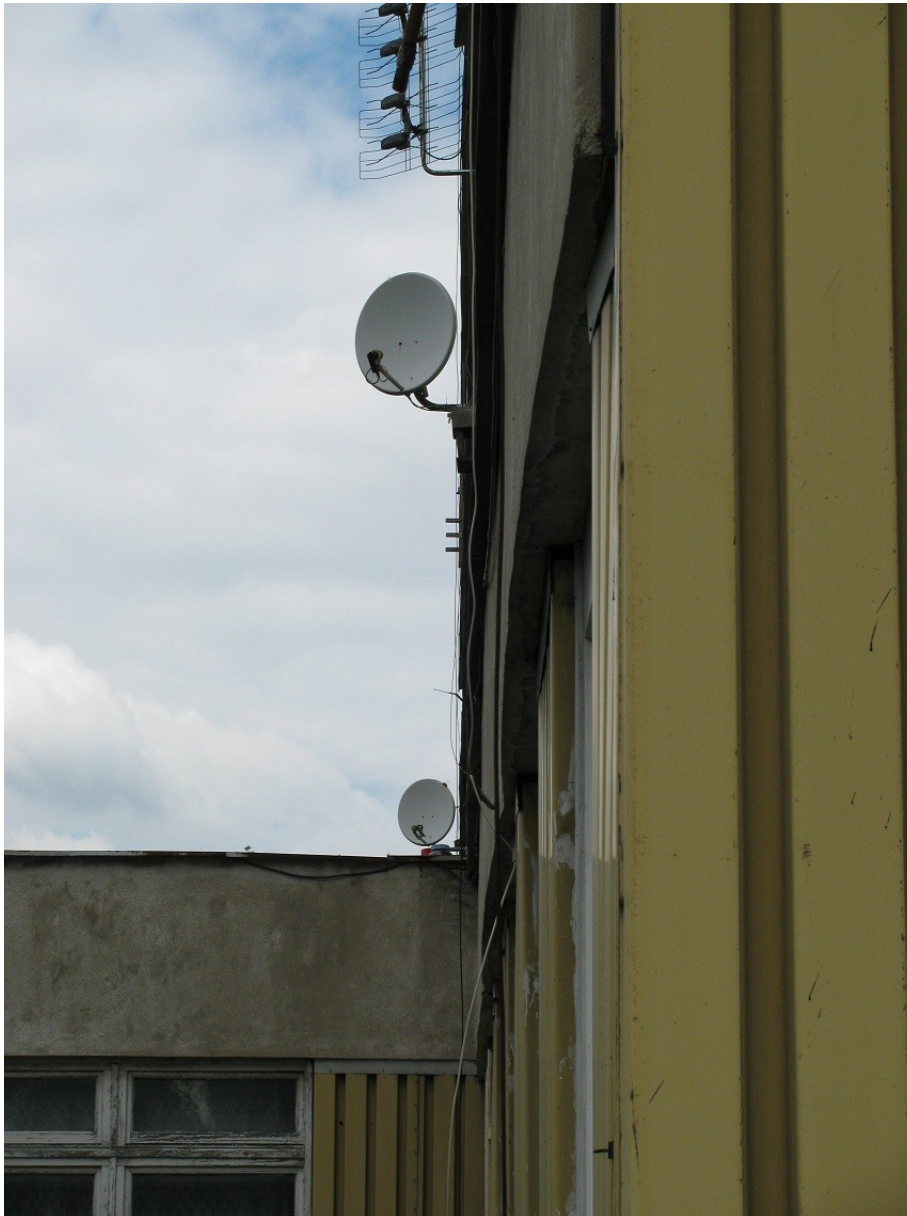
Ilustracja 12: Płyty elewacji tylnej. Widoczne wybrzuszenia
