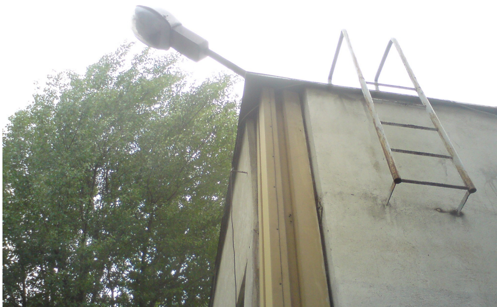
Ilustracja 15: Widoczne odchylenie płyty elewacyjnej od pionu
