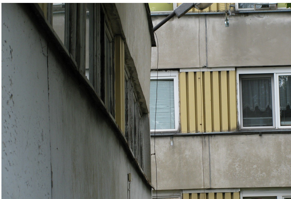
Ilustracja 16: Widoczne odchylenie płyty elewacyjnej od pionu
