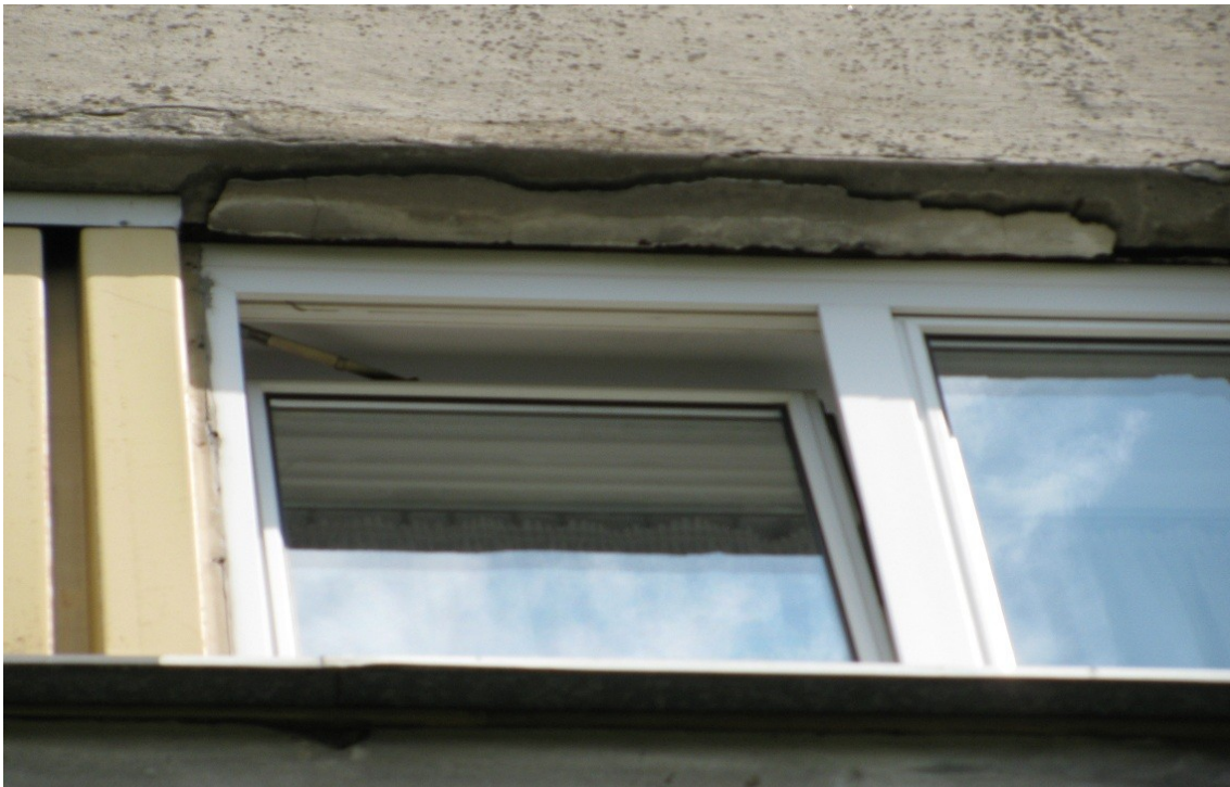
Ilustracja 13: Płyta elewacji zachodniej (tylnej). Widoczne zakrzywienie płyty, niedokładny montaż, uszkodzenia mechaniczne narożników płyt, odspojenie dolnej krawędzi, brak uszczelnienia styku płyt.
