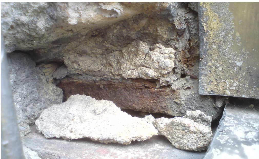
Ilustracja 11: Korozja wspornika płyty elewacyjnej
