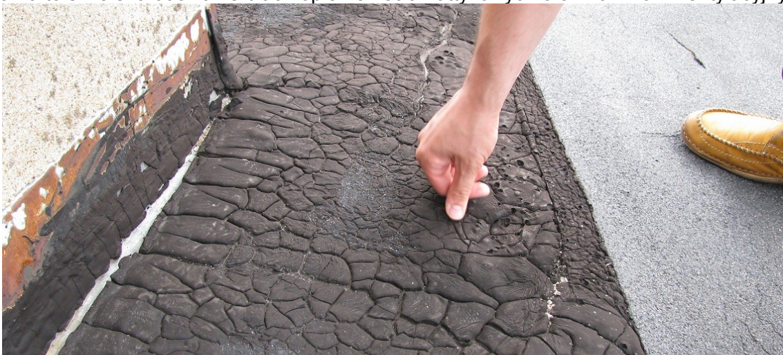
Ilustracja 14: Stan pokrycia dachu
