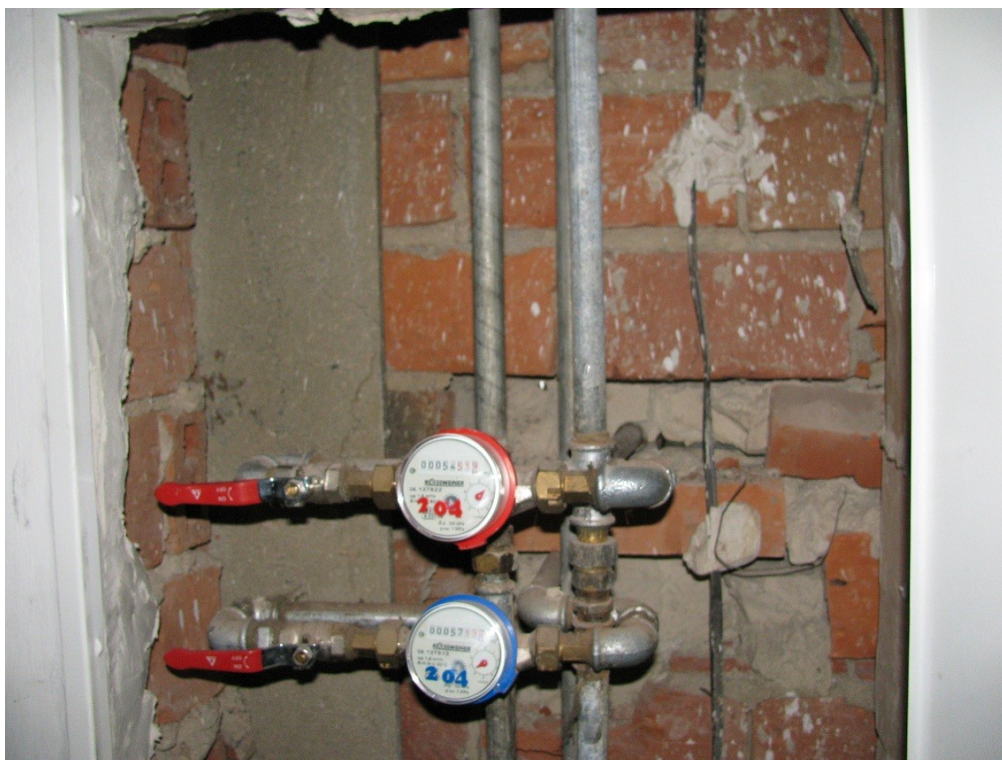
Ilustracja 6: Szacht instalacyjny. Widoczny słup stalowy.
