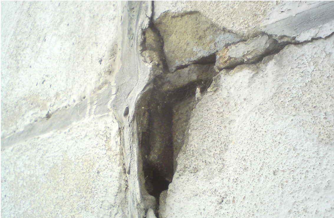
Ilustracja 17: Braki uszczelnienia styków płyt na elewacji
