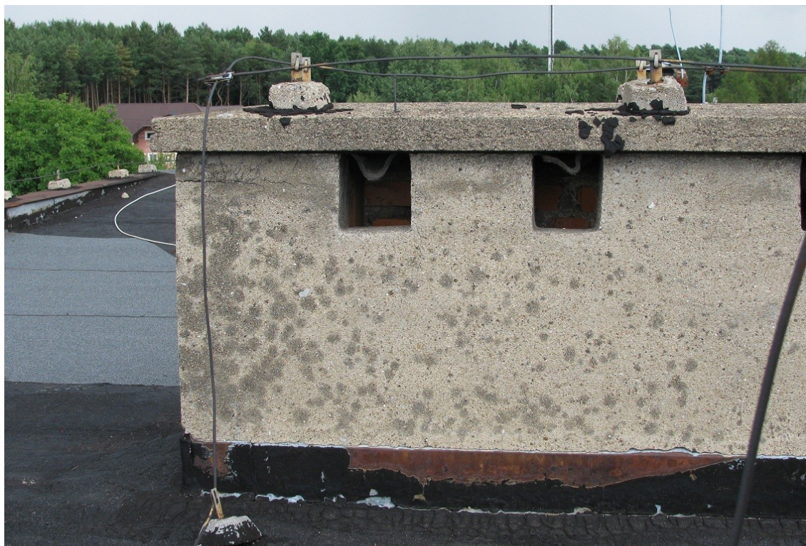
Ilustracja 8: Komin wentylacji grawitacyjnej
